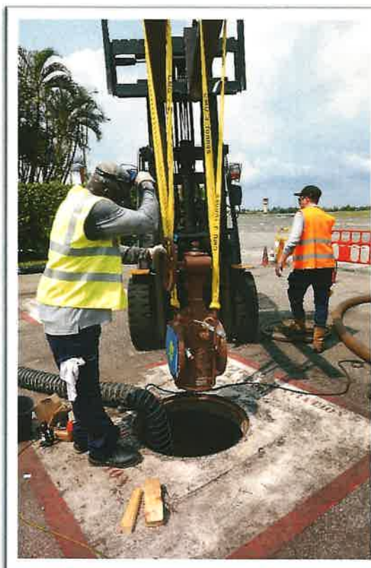
Descente de la vanne DBB
