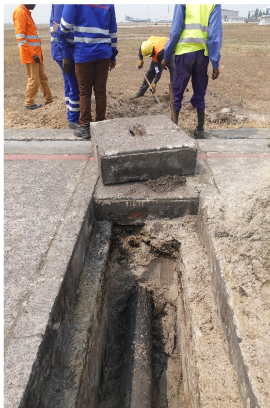
Conduite en caniveau
