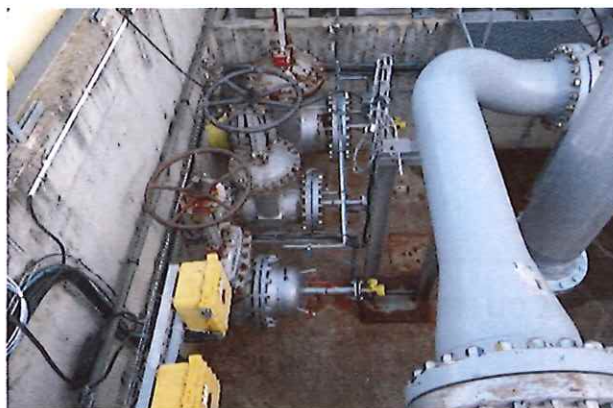
Vue des points d'injection d'Azote
